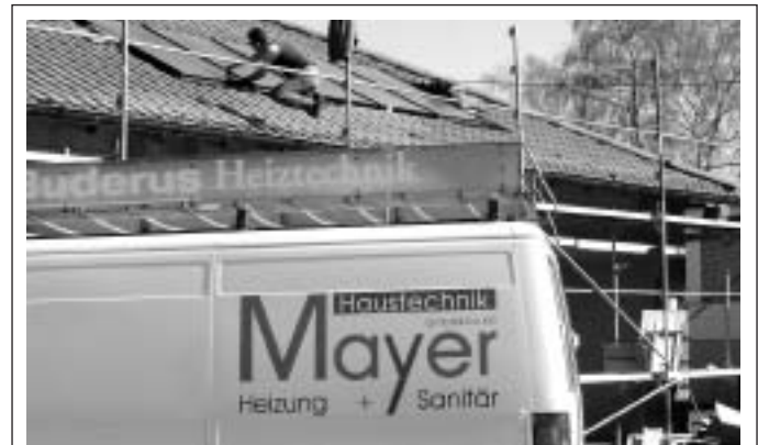
Umweltbewusst zeigt sich der SV Manching beim Bau seines neuen Geräte- und Umkleidehauses. Die Warmwasserversorgung wird durch eine Solarheizung gewährleistet, die von der Firma Haustechnik Mayer GmbH installiert wurde. Das Foto zeigt den Inhaber, Helmut Mayer, bei der Montage der Solarzellen.
