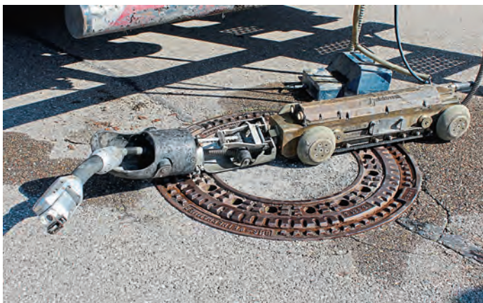
Klein und wendig: der Roboter filmt mit einer Kamera das Kanalnetz. Die Ingenieure können so Risse und andere Beschädigungen feststellen.
