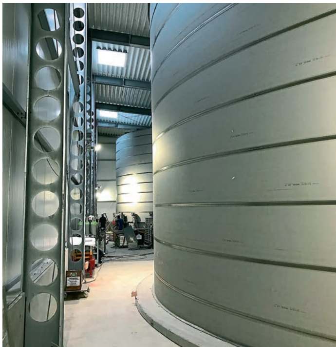
Die beiden neuen Edelstahltrinkwasserbehälter
